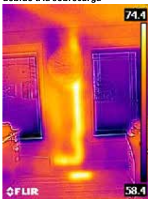
Tubo de drenaje caliente en la pared
