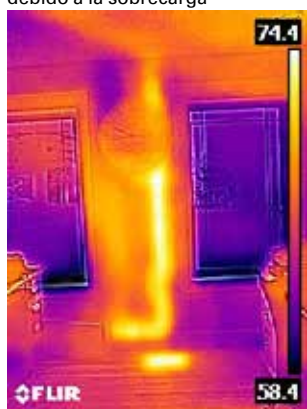
Tubo de drenaje caliente en la pared
